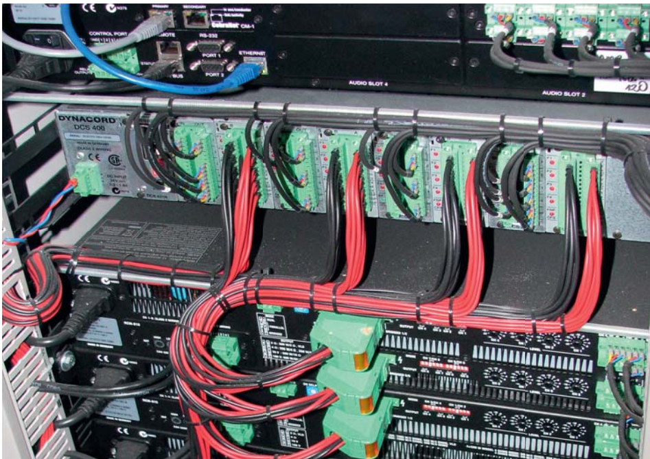
Pomieszczenia łączy ze sobą sieć CobraNet, z wykorzystaniem redundancji typu turbo-ring.
